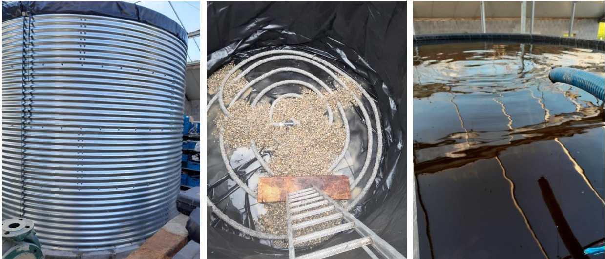
Figuur 2: Het filtersysteem bevindt zich in een waterdichte silo of tank met folie (links). Op de bodem bevinden zich drainageslangen in een grindlaag (midden). Bovenaan bevindt zich het drainwater dat moet gezuiverd worden (rechts). (Bron: Prinsheerlijke Aardbeien)
